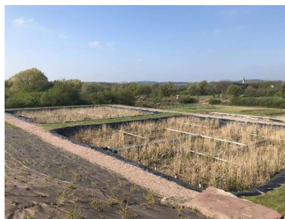
Filtre planté de roseaux – Altrippe Leyviller – 1 er étage
