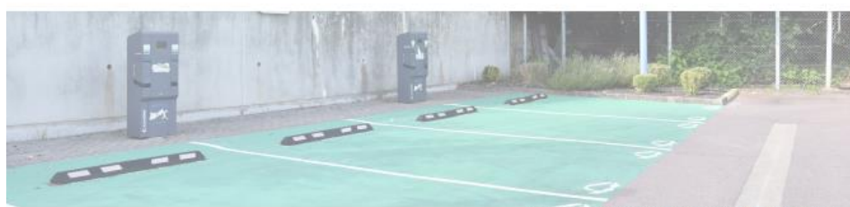
Borne de recharge à la gare ferroviaire SNCF à Valmont
